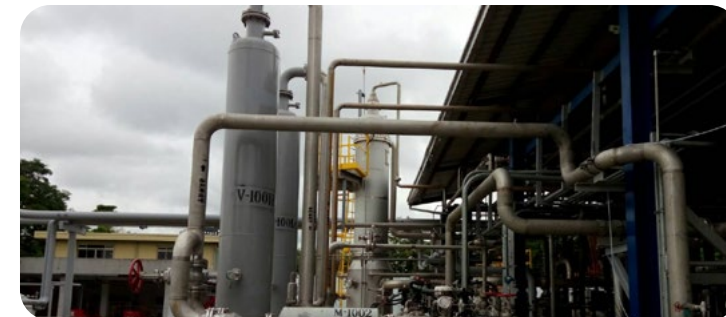
圖 薄膜油氣回收設備
