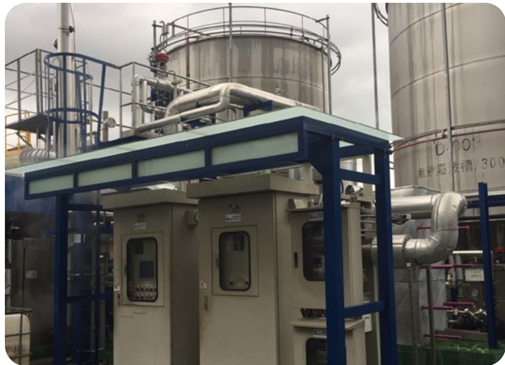
圖 化學廢液回收再利用設備
