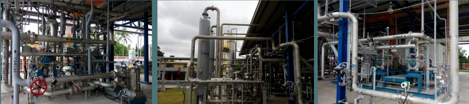
薄膜油氣回收設備
